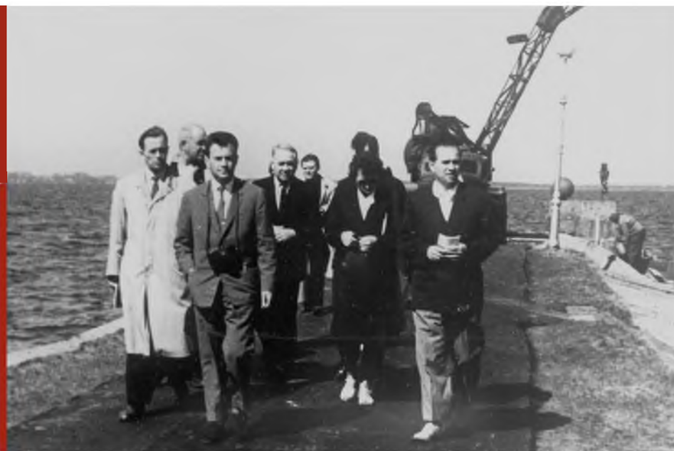
Работники Центрального музея В. И. Ленина осматривают пирс во время ремонтных работ 8 мая 1963 г. Фото П. Е. Никитин Работы по созданию пирса Государственный историко-мемориальный музей «Смольный»
